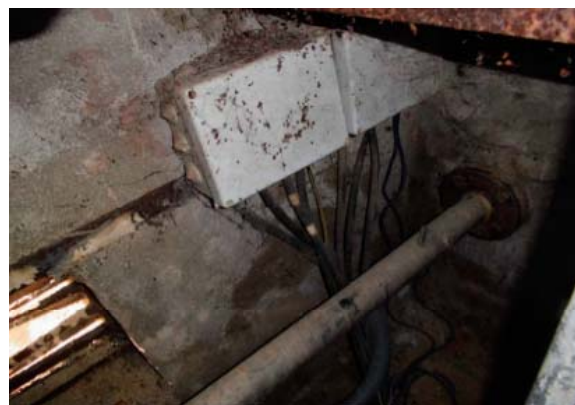
Imatge 3 Instal·lació elèctrica.
