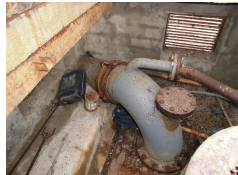
Imatge 11. Canonada d'impulsió, cambra 1.
