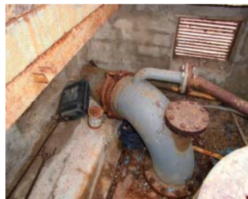
Imatge 4 Cambra 1, canonada d'impulsió.
