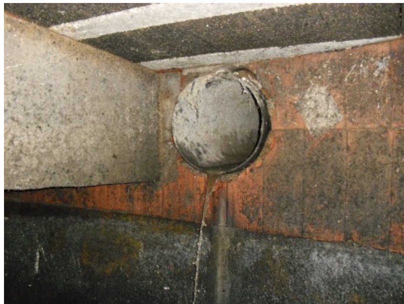
Imatge 156. Canonada desguàs, interior cambra 3.
