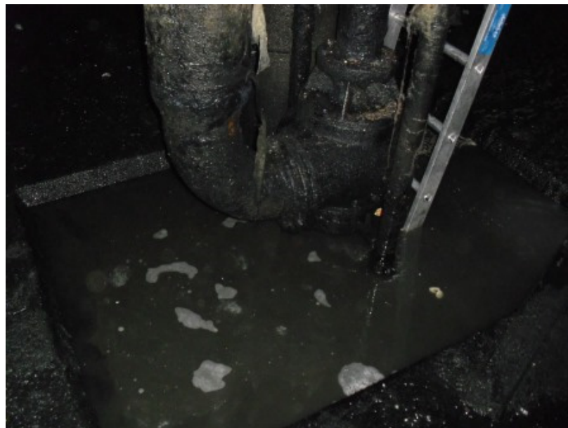
Imatge 13. Emplaçament bomba, cambra 3.
