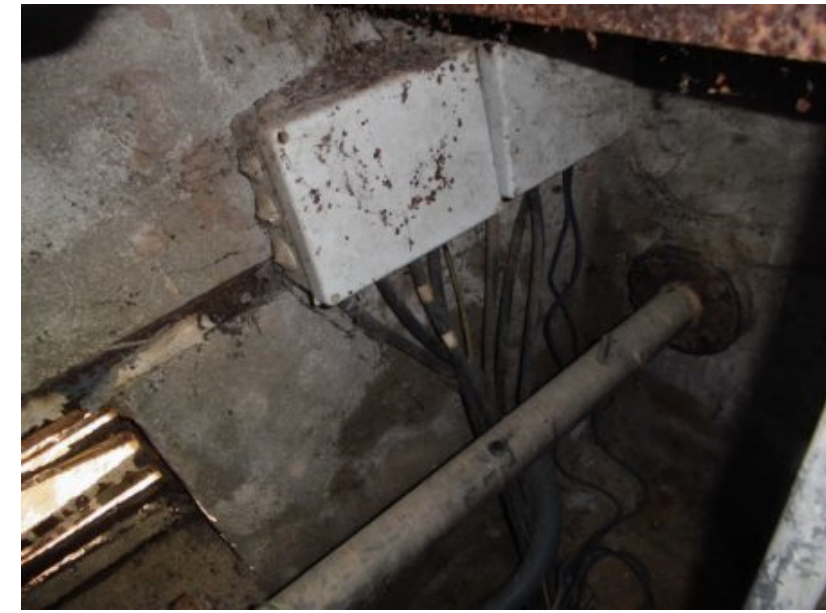
Imatge 10. Comandaments elèctrics, cambra 1.
