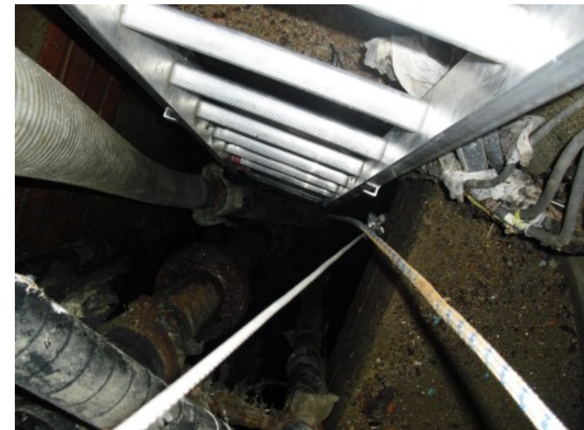
Imatge 189. Interior EBAR.
