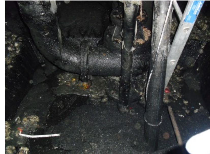
Imatge 14. Sistema aspiració/impulsió i tubs de neteja.
