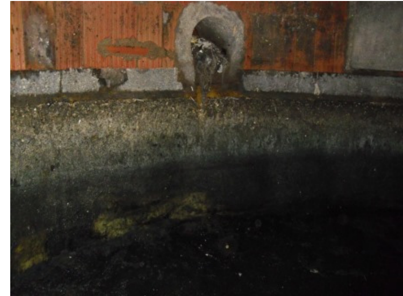
Imatge 178. Canonada desguàs, cambra 3.
