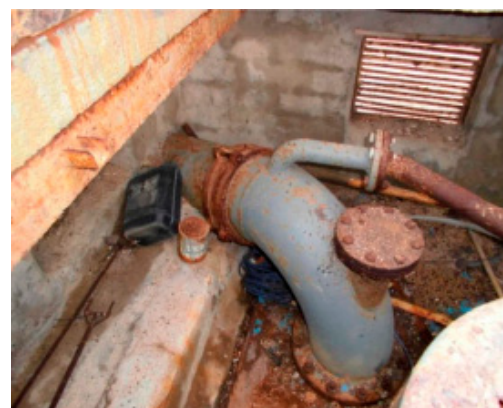
Imatge 4 Cambra 1, canonada d'impulsió.
