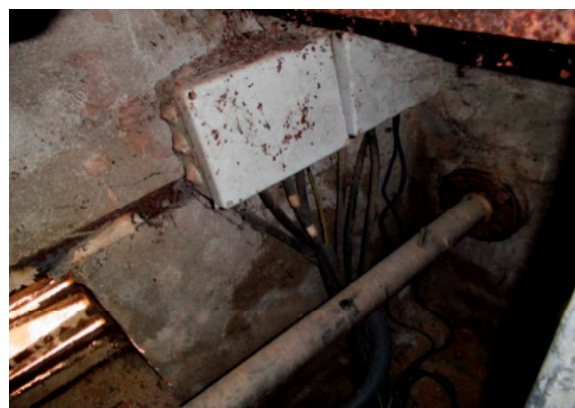
Imatge 3 Instal·lació elèctrica.
