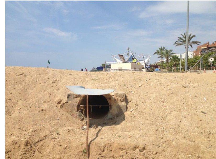
Imatge 2. Desguàs sobreixidor.
