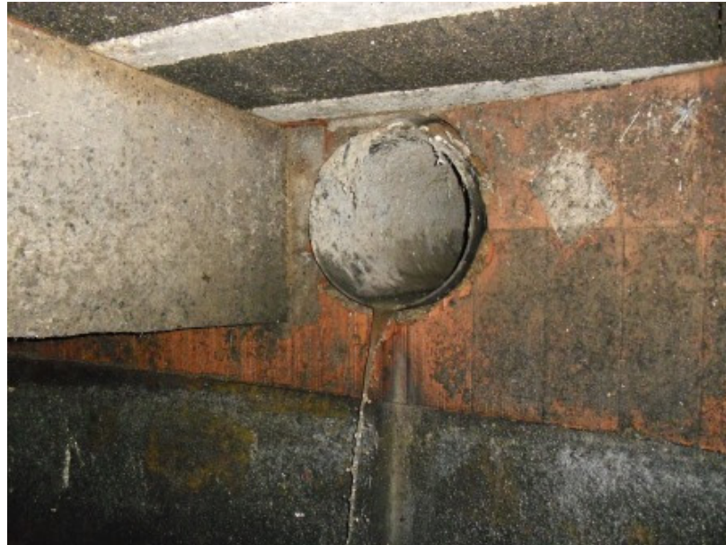
Imatge 156. Canonada desguàs, interior cambra 3.
