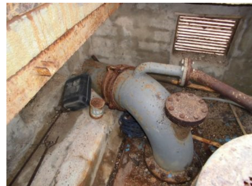
Imatge 11. Canonada d'impulsió, cambra 1.
