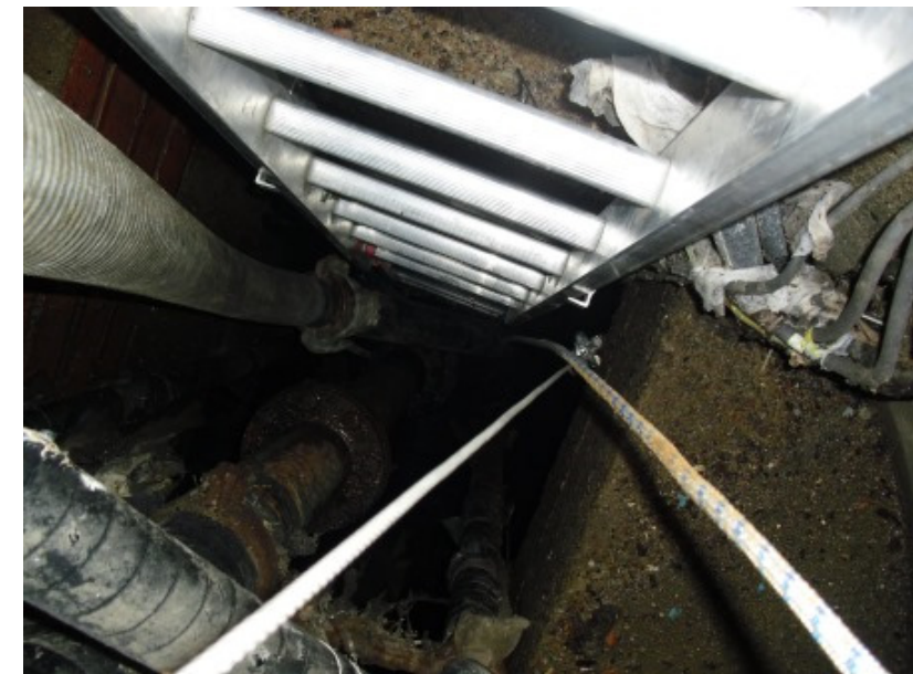
Imatge 189. Interior EBAR.
