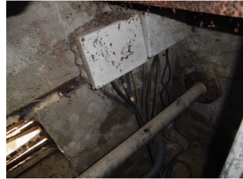
Imatge 10. Comandaments elèctrics, cambra 1.
